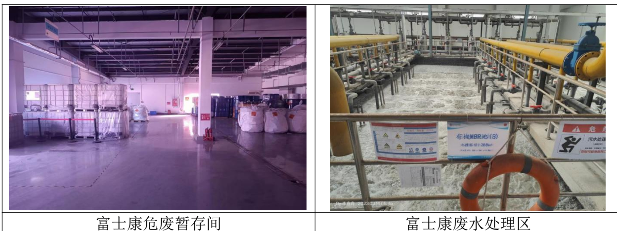
图 4.4-7 富士康废气处理设施、危废暂存间、废水处理区现场图
